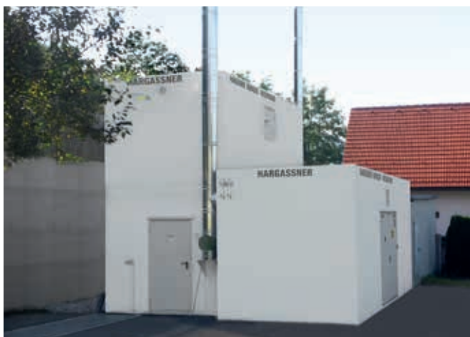
3-х модульна котельня при ресторані
